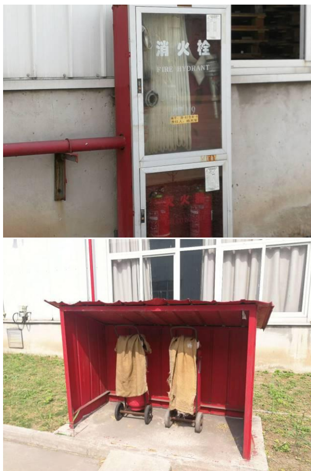
图5.2-3 仓库消火栓及移动式消防灭火器
