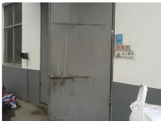
图 5.6-2 风机置于封闭厂房内
