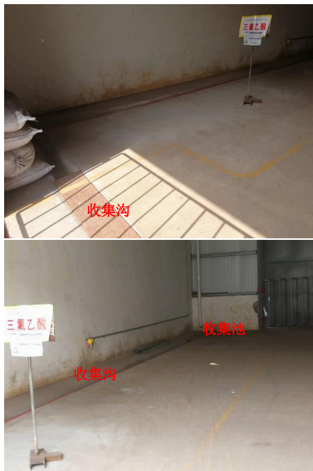
图 5.3-4 B-5 仓库地沟级收集池
