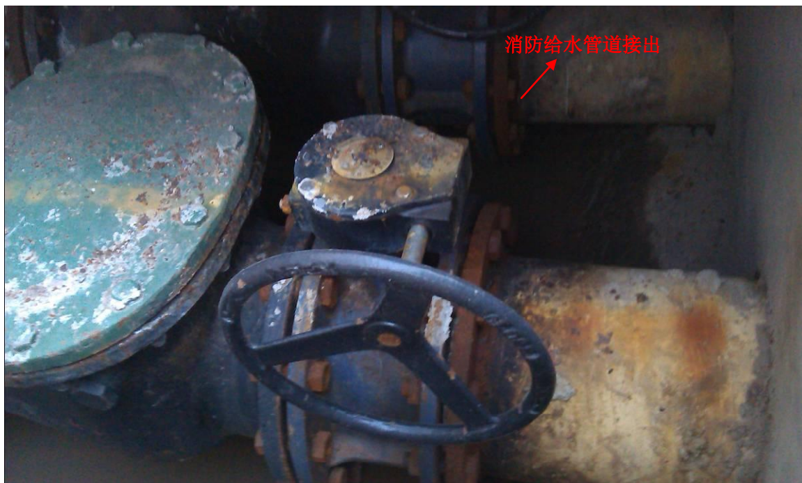
图5.2-2 南区消防泵房引至北区的消防给水管道
