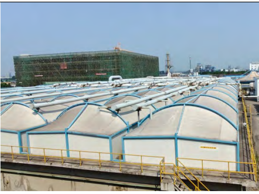
初期雨水池（北厂区改造）
