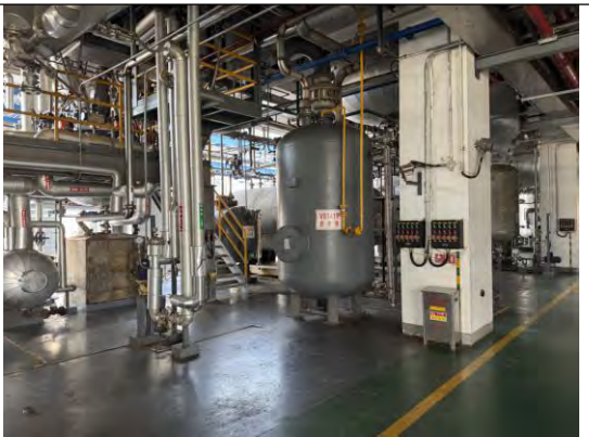
生产车间应急槽
