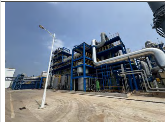
危废焚烧装置
