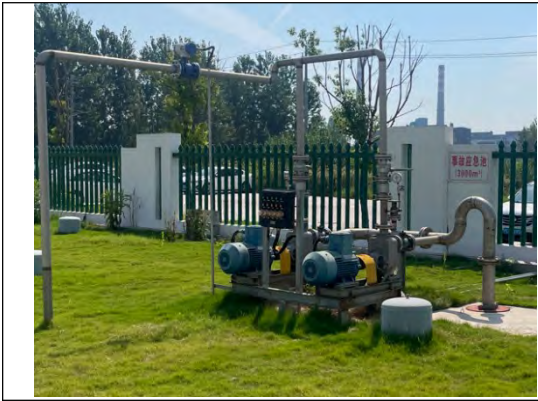
事故应急池控制系统（动力输送）
