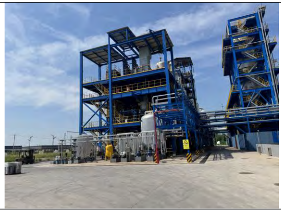
含氟废水焚烧装置
