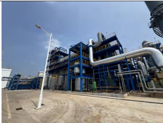
危废焚烧装置（高浓度有机废水）
