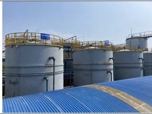
高浓氨氮、含甲苯废水罐
