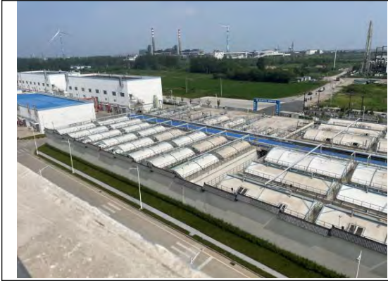
厂区污水处理站全景图 1
