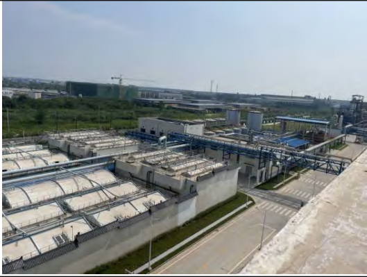
厂区污水处理站全景图 2
